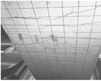
(a)混凝土板裂缝分布
