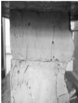
(a) 竖向裂缝出现
