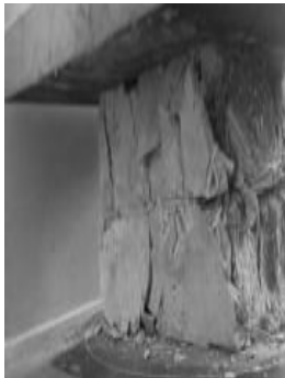
(c) 斜裂缝出现、发展
